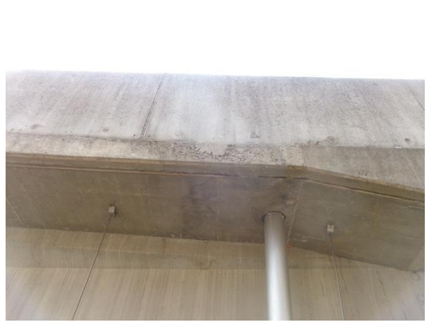
안터교 바닥판하면 S1 측면 재료분리 1.0*0.2
