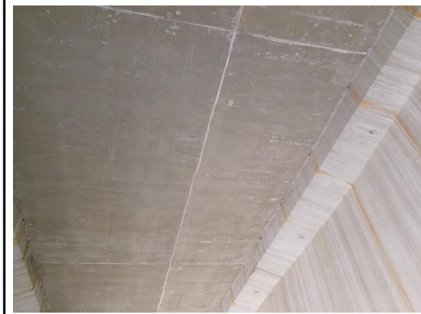
안터교 바닥판하면 S1 종방향균열 0.2/3.0
