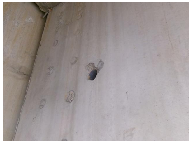
안터교 거더 S1-G4 A1측 인양홀 파손 0.2*0.2
