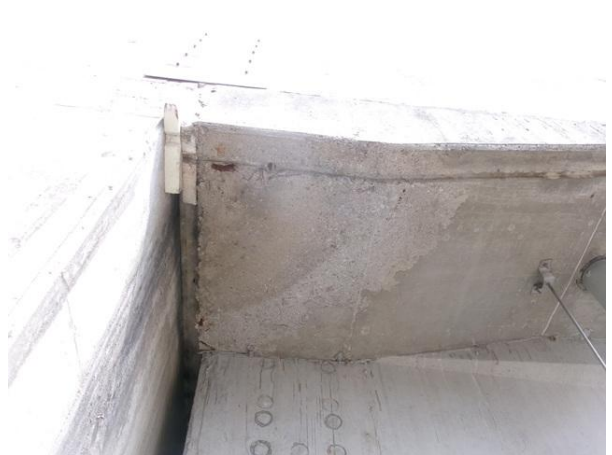
안터교 바닥판하면 S1-A2 박리 1.0*1.0
