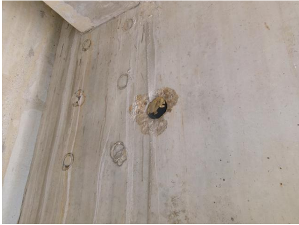
안터교 거더 S1-G1 A1측 인양홀 파손 0.2*0.2
