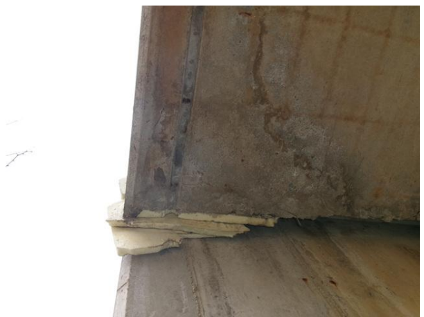
안터교 바닥판하면 S1-A1 횡방향균열 0.2/0.3
