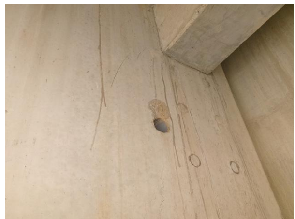
안터교 거더 S1-G7 인양홀 파손 0.2*0.2 좌
