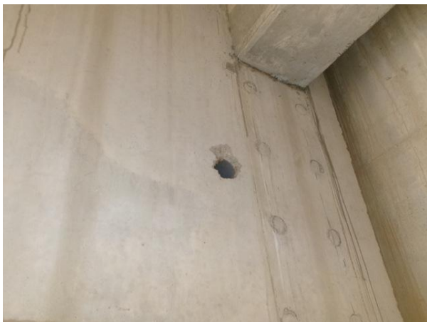
안터교 거더 S1-G2 인양홀 파손 0.2*0.2 우
