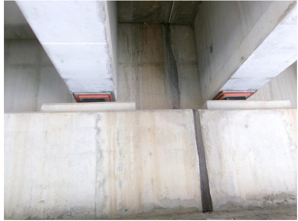
안터교 교대 A1 누수흔적 4.0*1.0_신규
