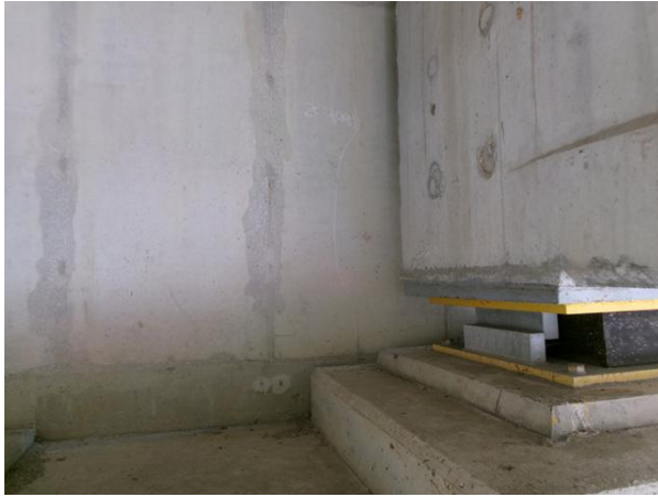
안터교 교대 A1 균열 0.2/1.0_신규
