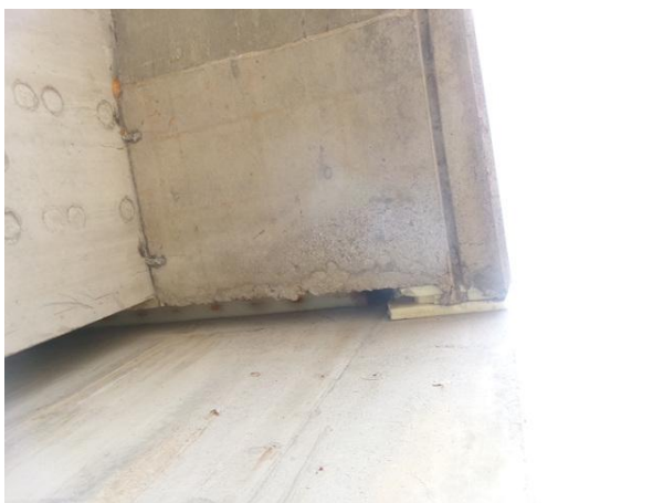
안터교 바닥판하면 S1-A2 박리 0.5*0.3
