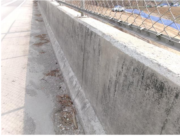
안터교 이천방향 방호벽 S1 열화 30.0*0.5*2
