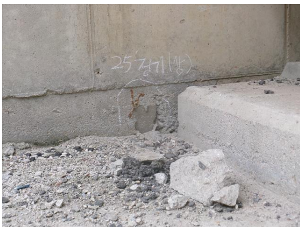
안터교 교대 A1 파손 0.3*0.3_신규
