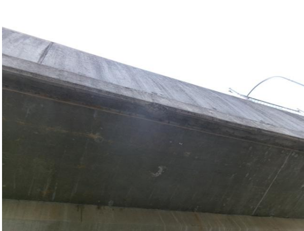
안터교 바닥판하면 S1 콘크리트 파손 0.1*0.2
