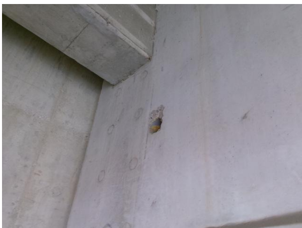
안터교 거더 S1-G4 인양홀 파손 0.2*0.2 좌
