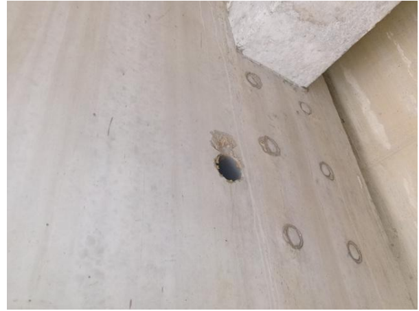
안터교 거더 S1-G1 인양홀 파손 0.2*0.2 우
